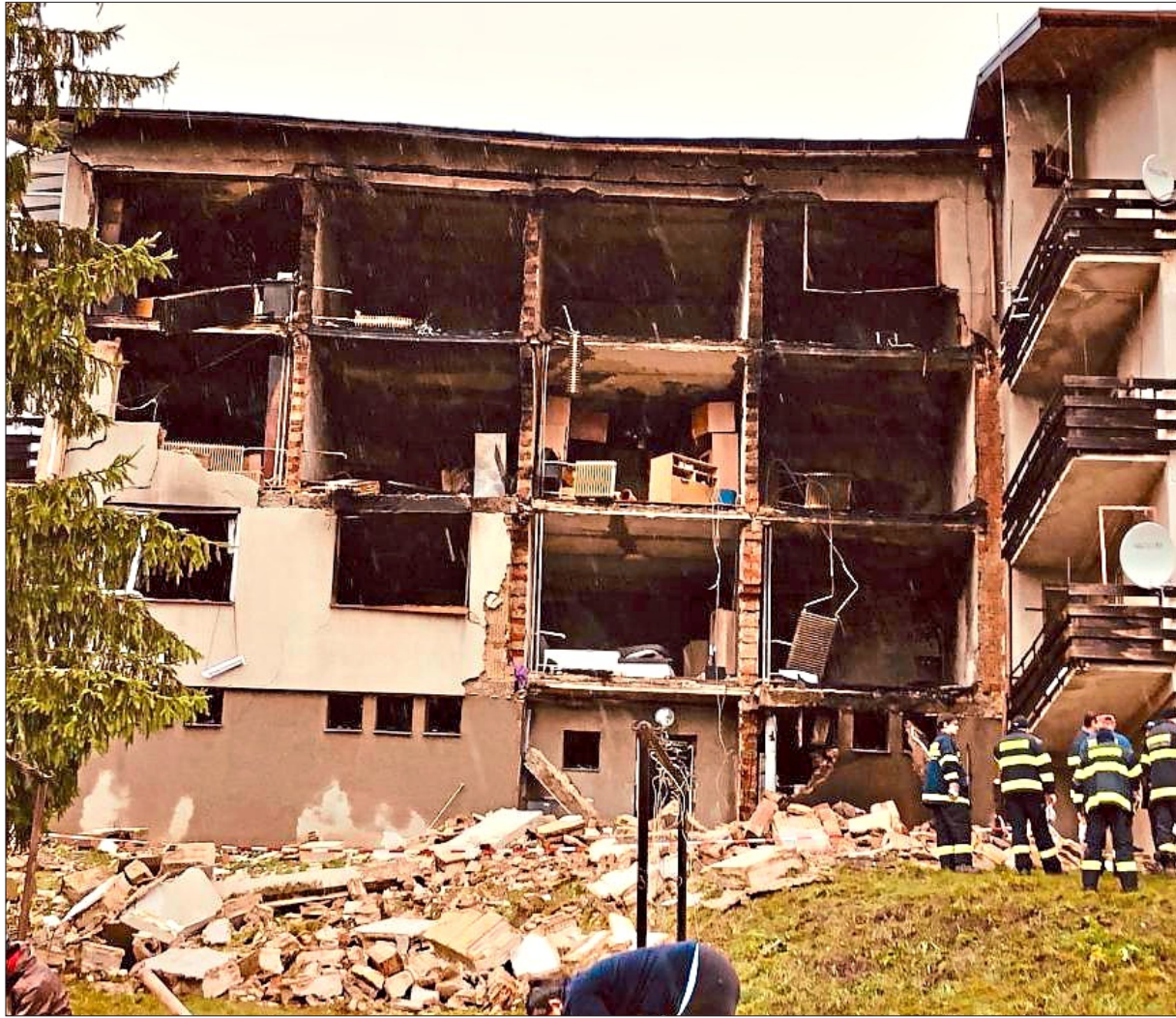
Nicht mehr bewohnbar: Total zerstört wurde das Mehrfamilienhaus bei der Explosion. Die Polizei ermittelt derzeit, ob es einen technischen Auslöser für die Gasexplosion gab oder ob es eine vorsätzliche Tat war.
